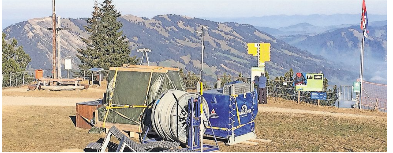
Bereits im Herbst 2016, vor dem grossen Schnee, wurden die ersten Winden und Seile für den Abbruch/Neubau auf den Berg transportiert. Bilder: Rita Baggenstos
